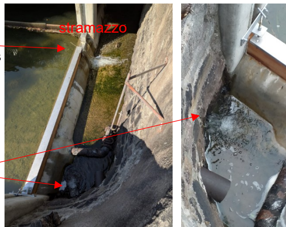
Ingresso da crepe muro
